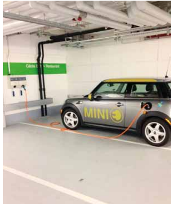
Bild 3: Ladestation in einer Garage
