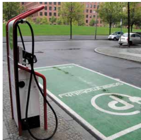
Bild 2: Markierung einer Ladestation
