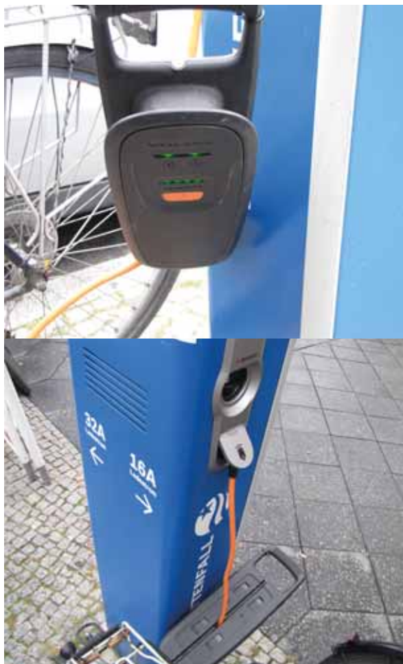
Bild 4: Ladeleitung im Einsatz
